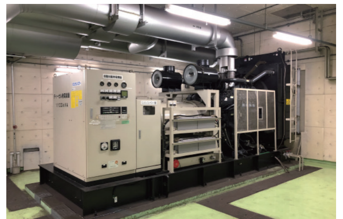
非常用発電機
