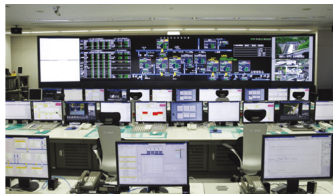
電力管理システム
