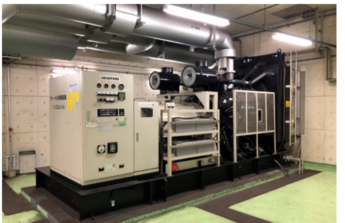
非常用発電機
