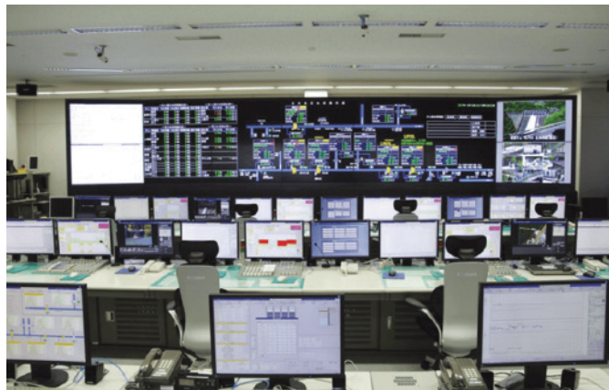
電力管理システム
