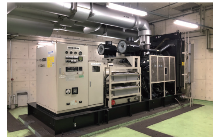
非常用発電機
