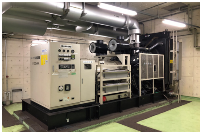
非常用発電機
