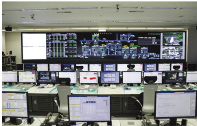
電力管理システム
