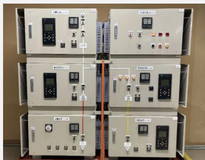
可搬式非常用制御盤写真
