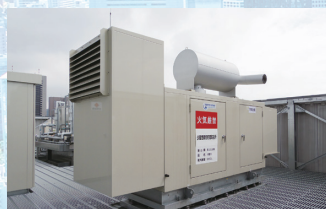
非常用発電機
